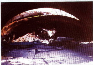
Noću 23/24. 03. 1999. uništeno je armiranobetonsko sklonište u kome se nalazio avion MiG-21 (17220)
