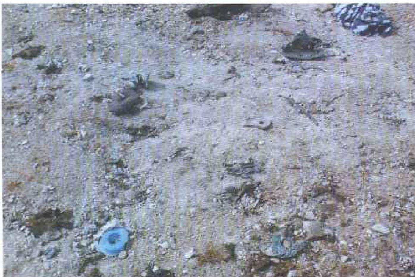
Слика 30 Шири изглед оштећеног асфалта са деловима
