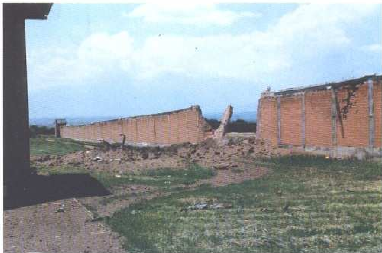
Слика 4 Део срушеног зида КПД „Дубрава“
