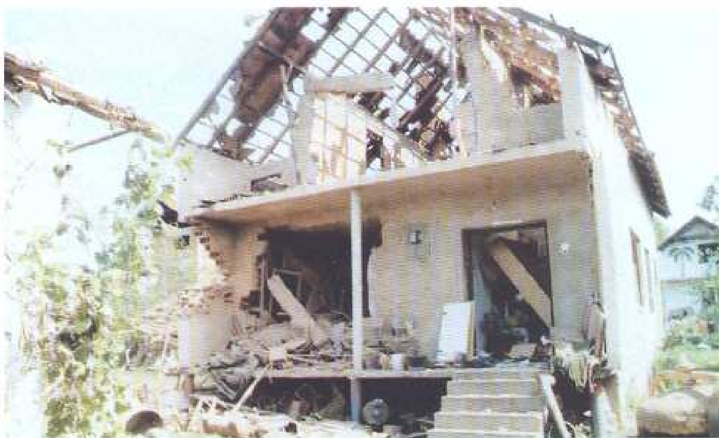
Слика 120 Срушена кућа у ул. Ужичка 10, власништво Рашић Мирослава. Дана 28. 05. 1999. године у Алексинцу срушено је и оштећено око 80 кућа, готово све у Ужичкој и Нишкој улици.
