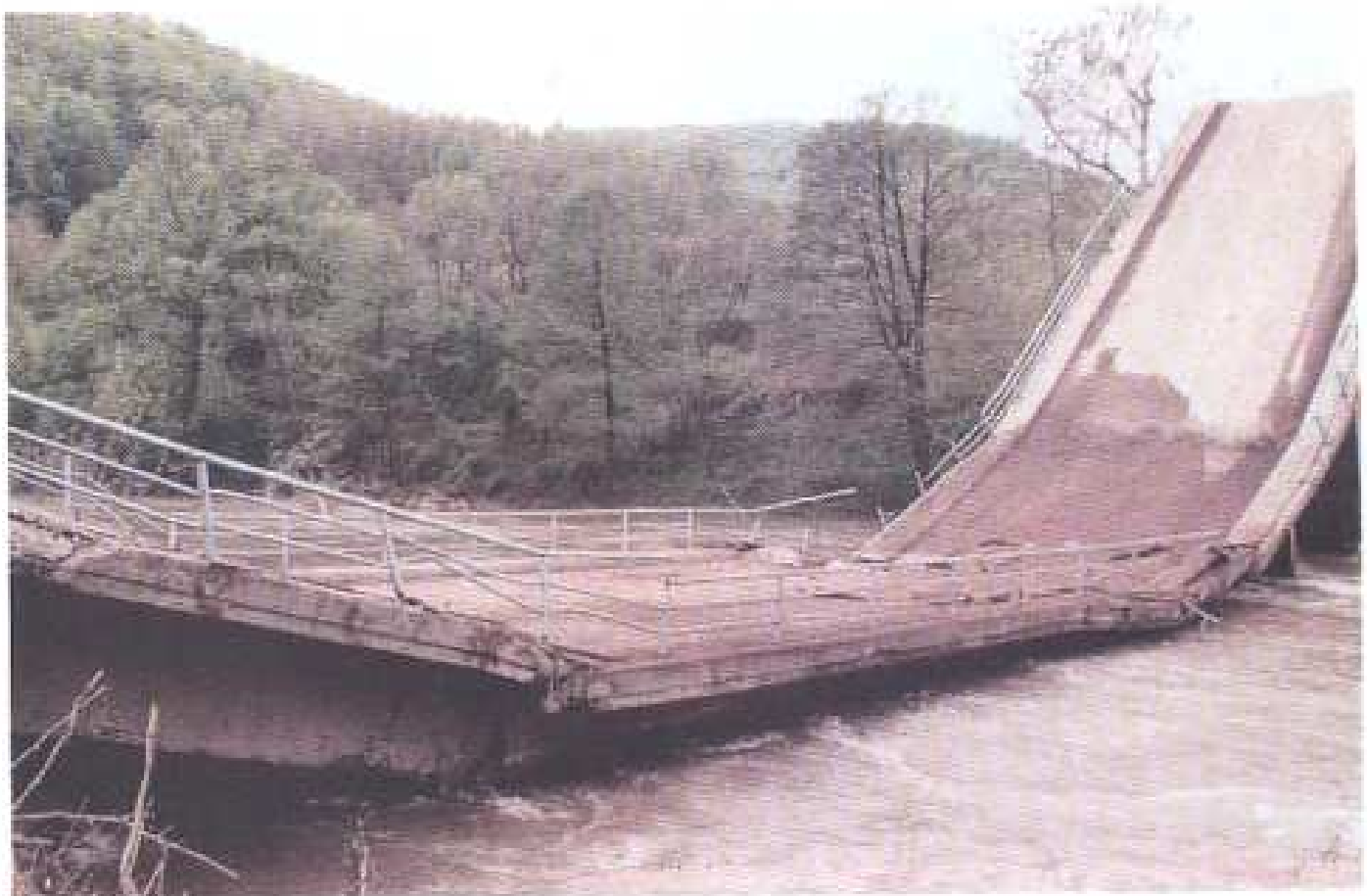
Слика 8 Ближи изглед срушеног „Сарајевског моста”
