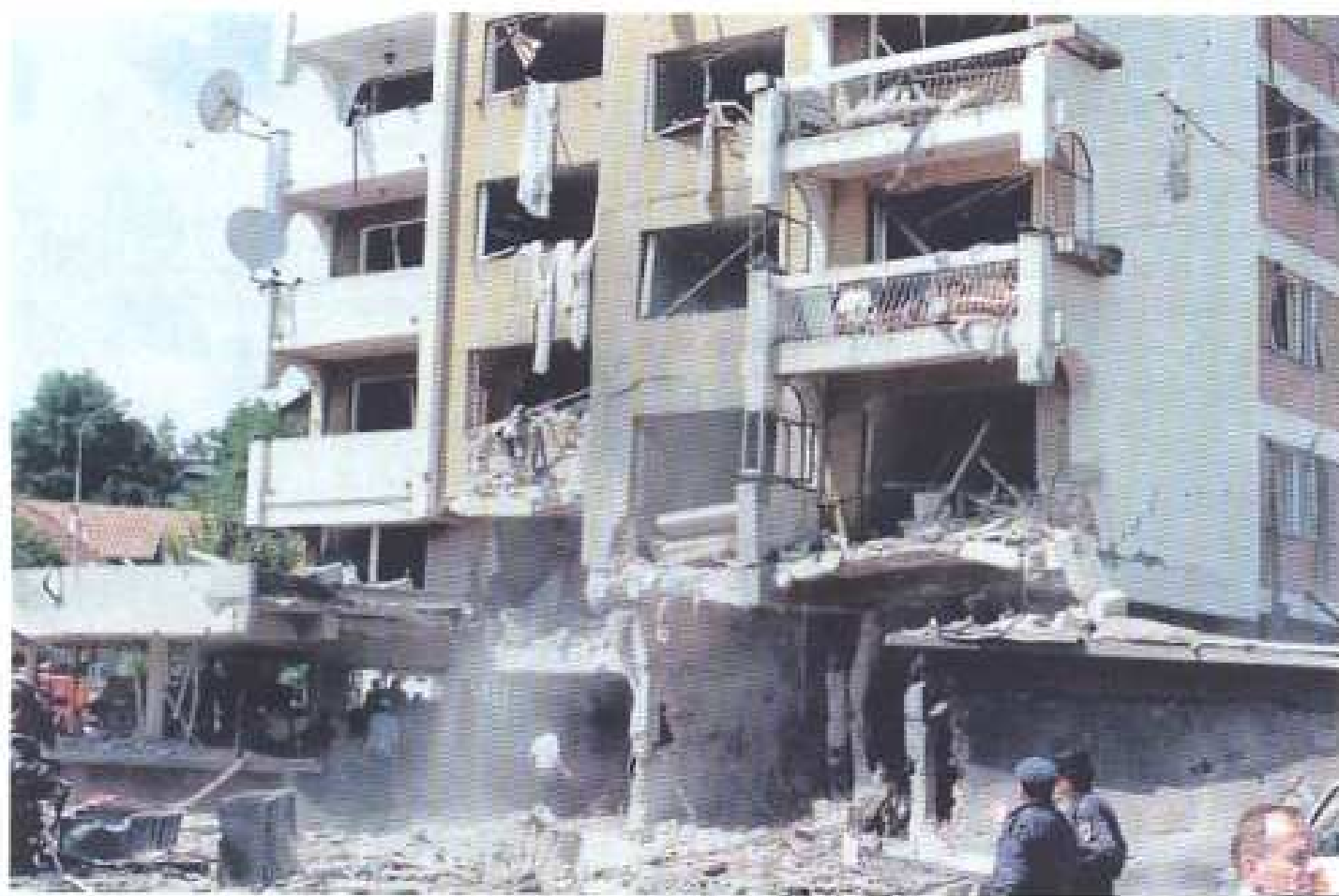
Слика 138. Ближи изглед разрушене зграде ул. Стевана Немање 74
