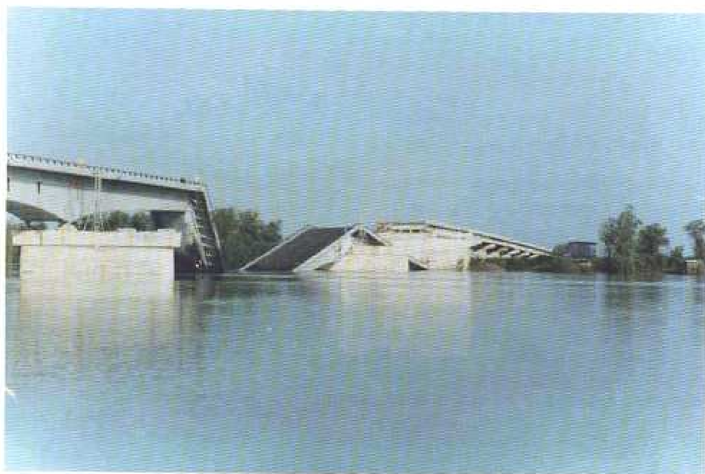
Слика 4 Шири изглед десне стране срушеног моста „Остружница“
