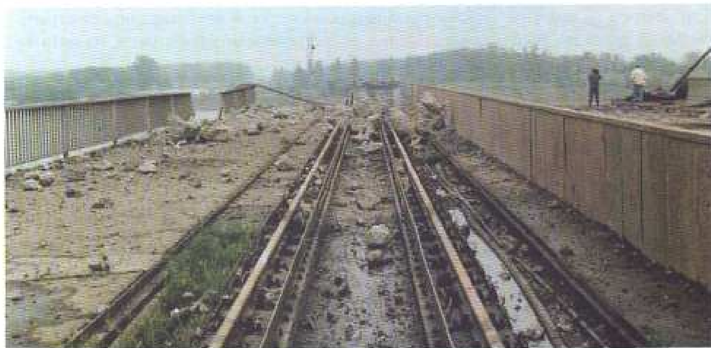
Слика 1 Срушени Жежељев мост на Дунаву – Нови Сад, дана 26. 04. 1999. године – пружни део (други напад)
